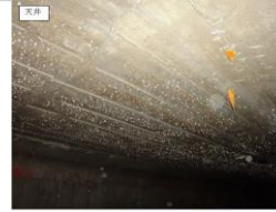
⑧ 箱桁内面の結露
