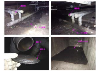
⑤ 塩ビ排水管蓋の脱落
