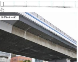
① 外面の遊離石灰
