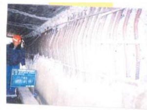
【神 P442（終点側）損傷状況】
