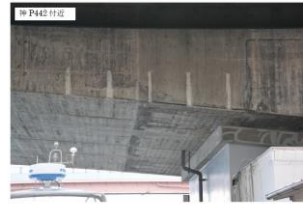
② セパレータ孔からの漏水跡
