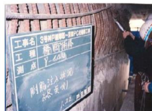
【神 P444（終点側）損傷状況】
