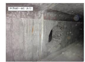
③ 箱桁内面打継目の遊離石灰
