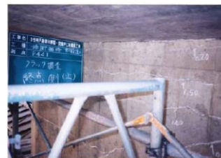
【神 P441（終点側）損傷状況】
