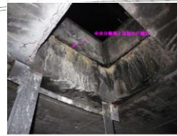
⑦ マンホールからの漏水跡
