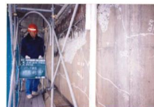
【神 P443（終点側）損傷状況】
