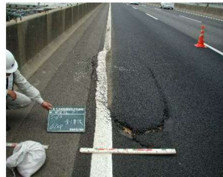
ずれを伴うひび割れ
