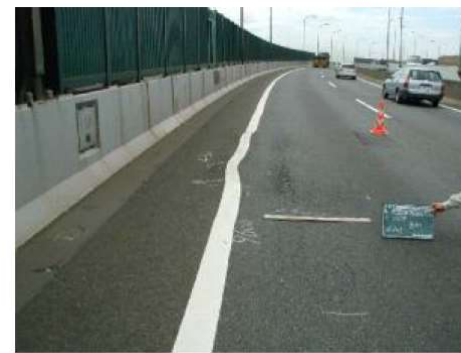
局地的なわだち掘れ
