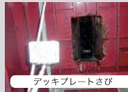
デッキプレートさび
