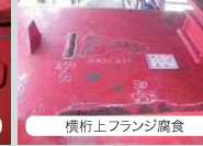
横桁上フランジ腐食
