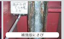
補強版にさび
