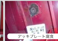
デッキプレート腐食
