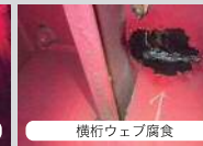
横桁ウェブ腐食
