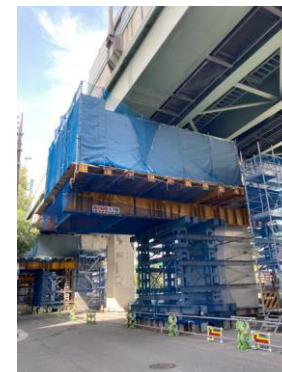
中央大通（側道）固定規制及びRC橋脚梁拡幅工（2021年3月19日撮影）
