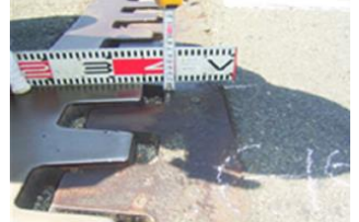
鋼製伸縮継手の損傷
