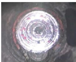
床版底面/鋼板はく離
