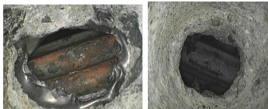
シース内損傷状況
