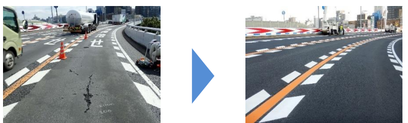
舗装の劣化・損傷
