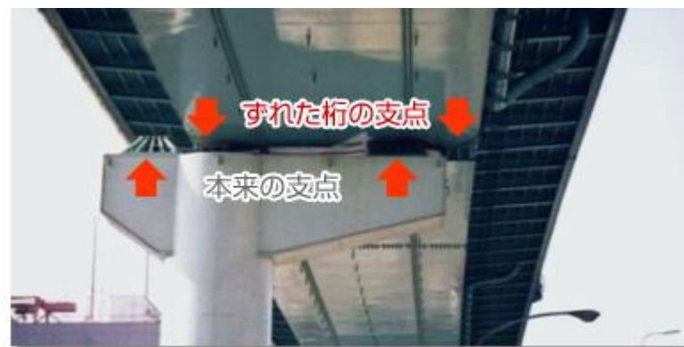
震災時の桁のずれ
