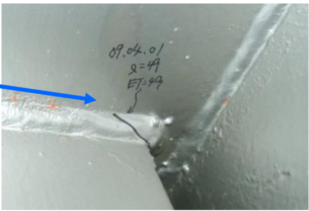
き裂状況 (平成17年)
