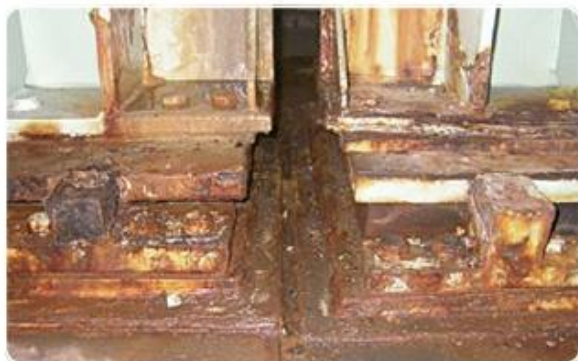
鋼桁端部の腐食
