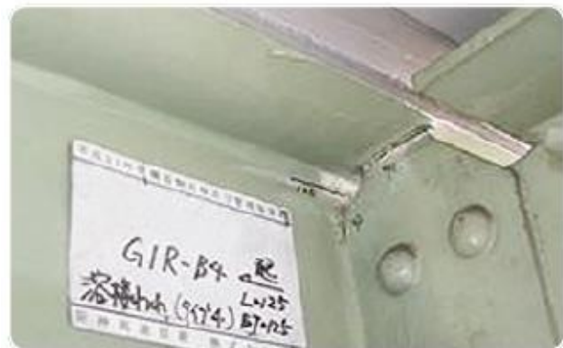
鋼桁の接合部に発生した疲労き裂
