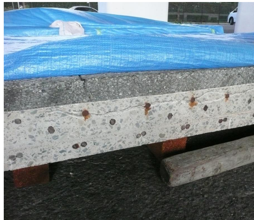
〔水平ひび割れの状況〕
