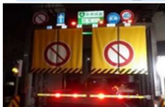
入口遠隔閉鎖装置の整備
