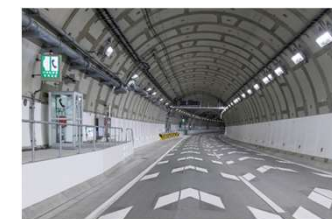
LED道路照明(トンネル内)
