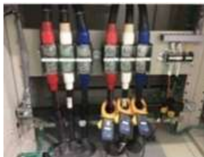
ジェットファンの診断: ジェットファンの電流値から電動機内部の正常/異常を判定、吊り金具の異常も検出可能
