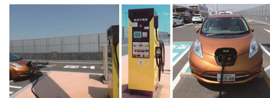
パーキングエリアに設置の電気自動車用急速充電器
