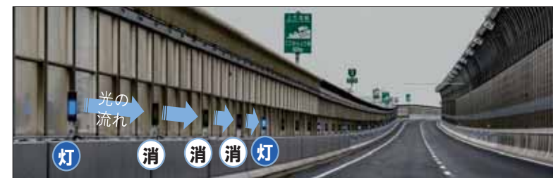
[深江付近に設置した速度回復誘導灯]
