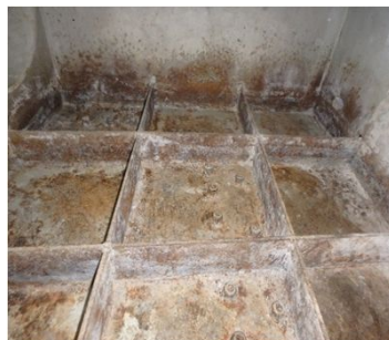
〔錆の状況(下面)〕
