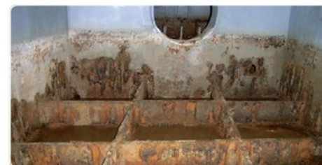
滞水の痕跡が残り腐食が進む鋼製の基礎内部
