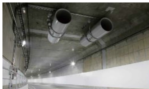
【淀川左岸線】 (インバータ制御ジェットファン)
