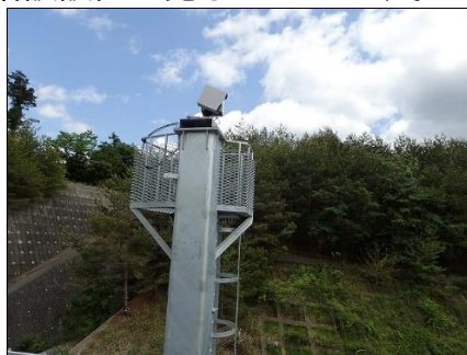
交通流監視カメラ設置例
