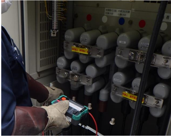
受配電設備点検
