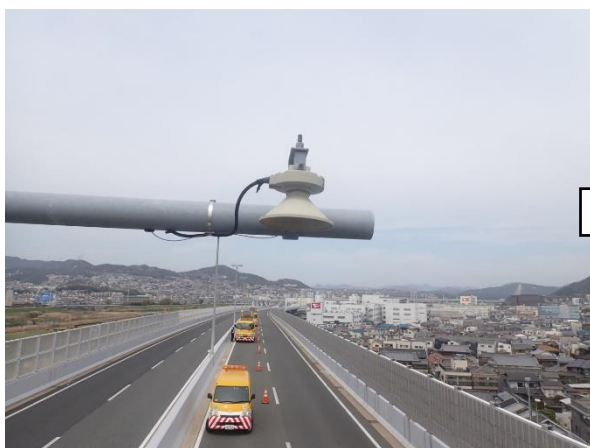
車両検知ヘッド補修前
