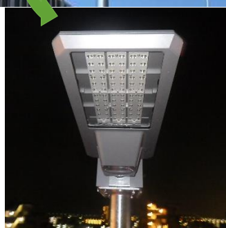
明かり部道路照明 (LED)
