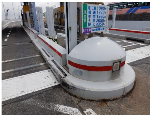
料金所アイランド損傷（補修前）
