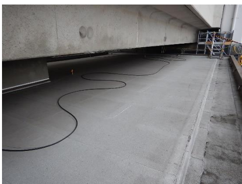
菱江施設基地事務所屋上防水 （補修前）
