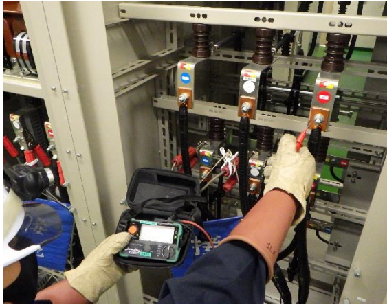
受配電設備点検
