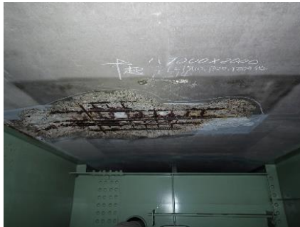
補修前（コンクリート床版のはく離）
