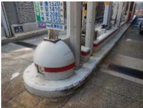
料金所アイランド損傷（補修前）
