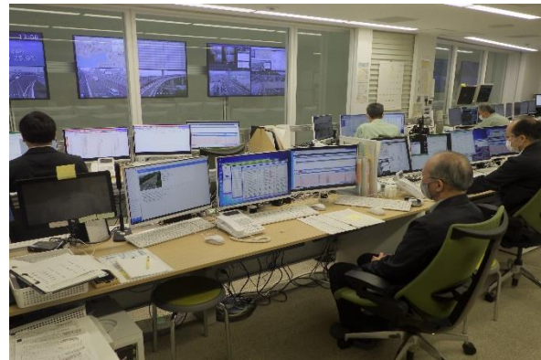
設備監視（兵庫地区）
