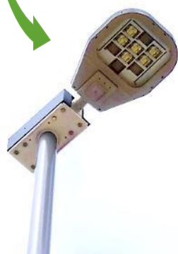
明かり部道路照明（LED）
