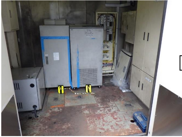
料金所無停電電源装置補修前
