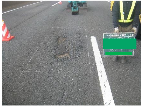
補修前（舗装の損傷）
