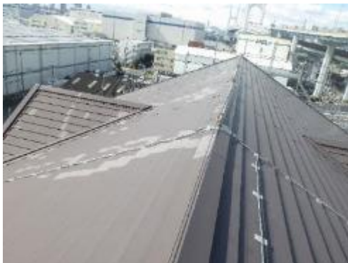
深江浜管理所屋上（補修前）
