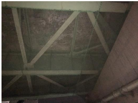
補修前（コンクリート床版のはく離）
