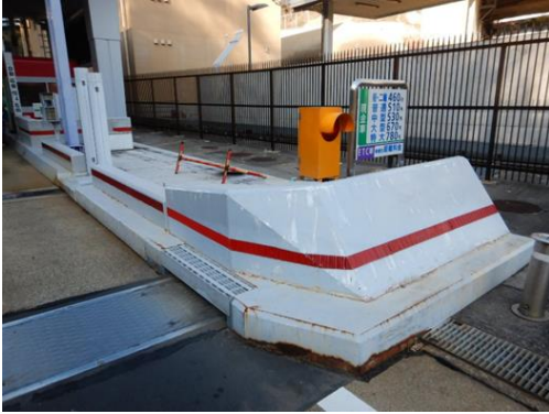
料金所アイランド損傷（補修前）
