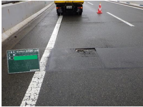
補修前（舗装の損傷）
