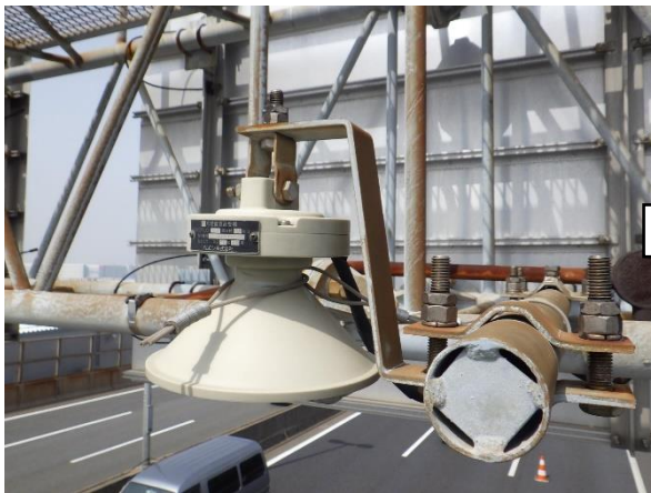
車両検知ヘッド補修前
