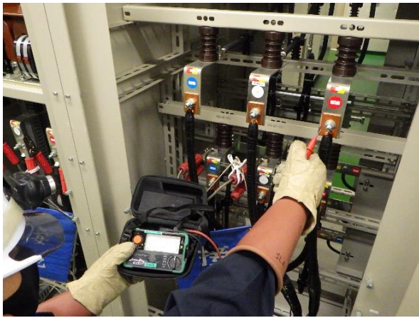
受配電設備点検
