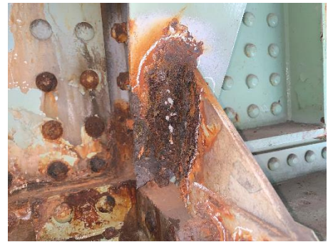
補修前（鋼部材の腐食）
