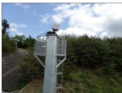
交通流監視カメラ設置例
