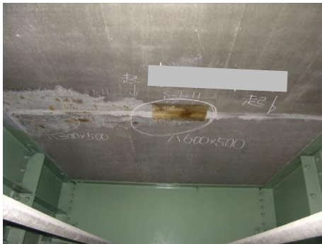
補修前（コンクリート床版のはく離）
