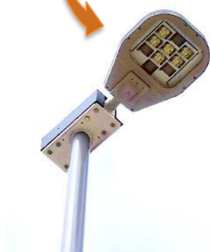
明かり部道路照明（LED）
