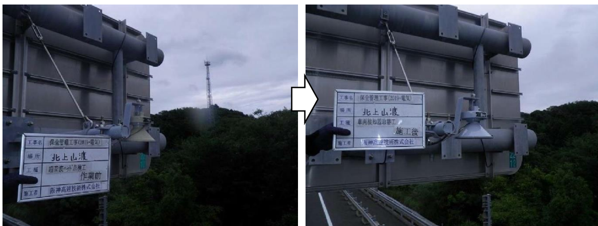
車両検知ヘッド補修前
