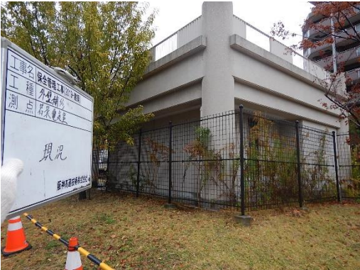
若菜電気室外壁（補修前）
