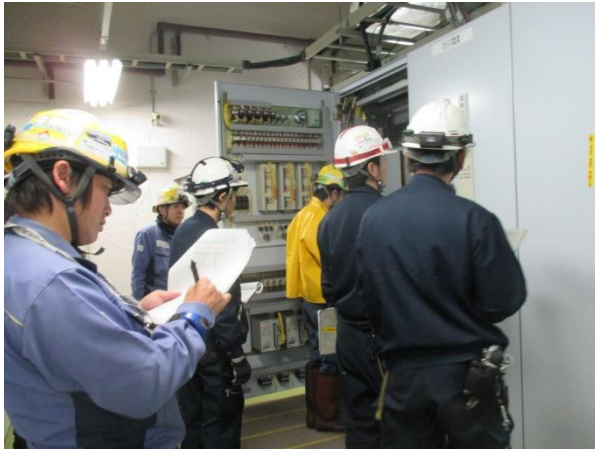
受配電設備点検
