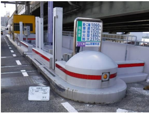
料金所アイランド損傷（補修前）
