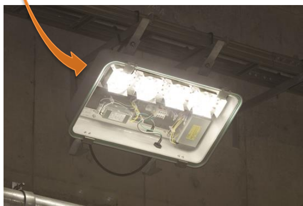
トンネル部道路照明（LED）
