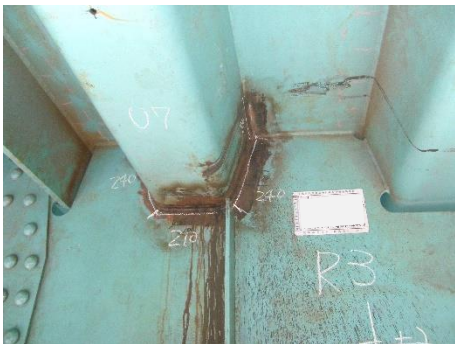
補修前（鋼床版のき裂）
