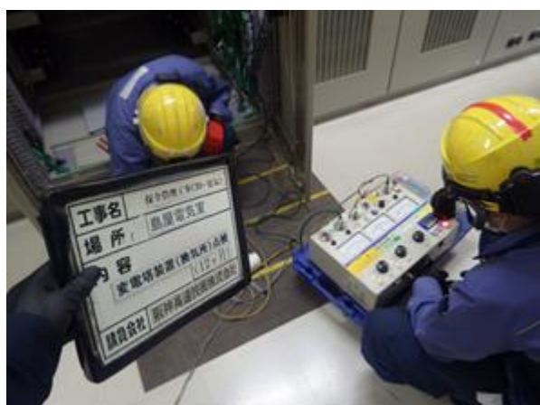
受変電設備点検
