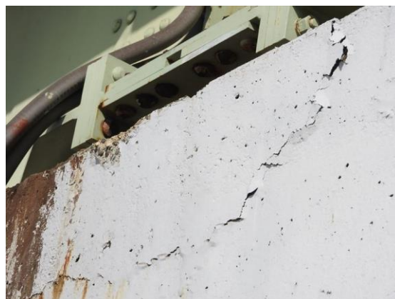
17号西大阪線：RC橋脚浮き
