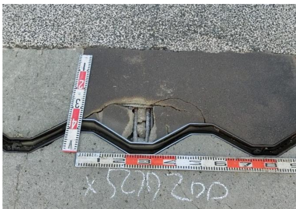
13号東大阪線：伸縮継手取付部剥離
