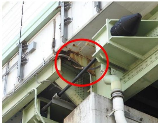
12号守口線：鋼桁端部さび腐食
