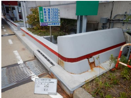
料金所アイランド損傷（補修前）
