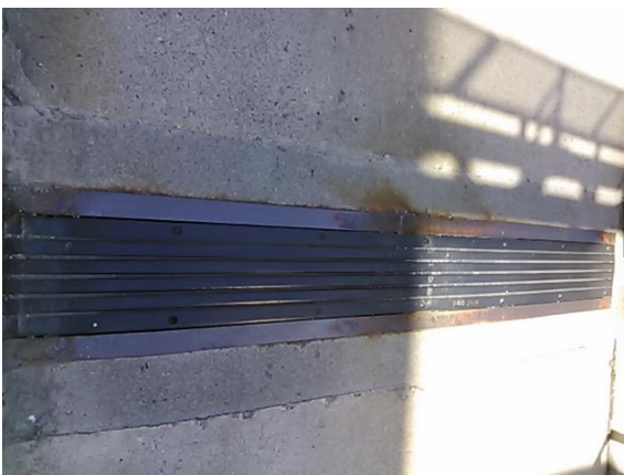
軸数検知器補修前
