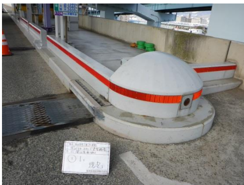
料金所アイランド損傷（補修前）
