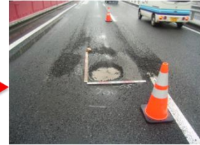
舗装の損傷 (ひび割れ・ポットホール)
