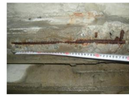
コンクリート高欄部の損傷 (剥離・鉄筋露出)
