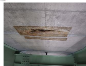
RC床版の損傷 (鉄筋露出)
