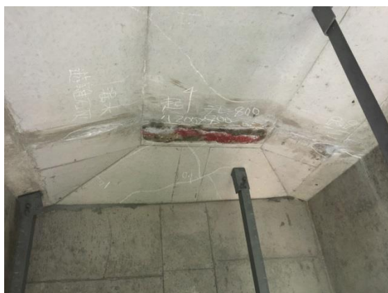
7号北神戸線：床版コンクリート剥落
