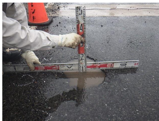
14号松原線：舗装ポットホール
