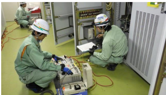
受変電設備点検
