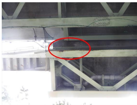
3号神戸線：鋼桁さび腐食
