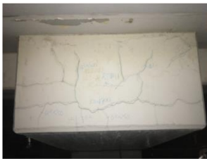
コンクリート桁の損傷 (ひび割れ)
