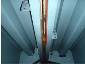
伸縮装置の損傷 (止水破損)
