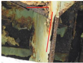
鋼桁部の損傷 (漏水による腐食)
