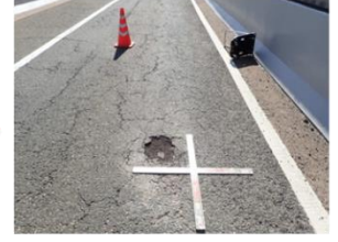
舗装の損傷 (ひび割れ・ポットホール)
