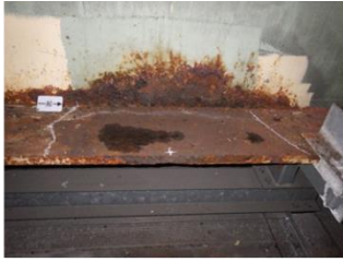
鋼桁部の損傷 (漏水による腐食)
