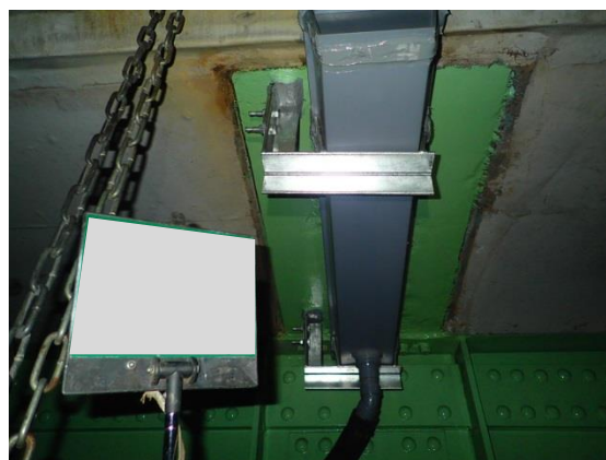
環状線 鋼桁端部さび・腐食（補修後）
