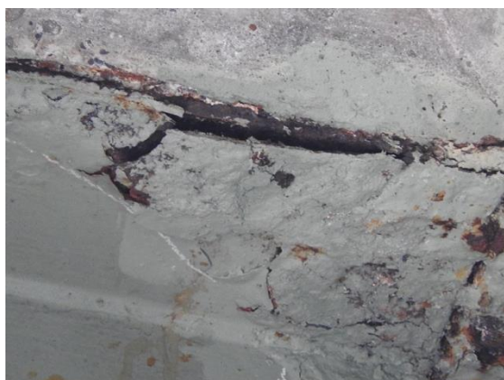
12号守口線：さび片の落下恐れ
