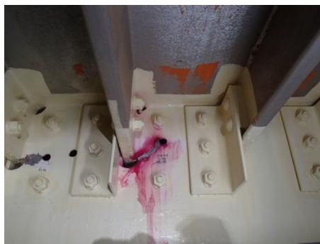
損傷状況（スカーラップ部）
