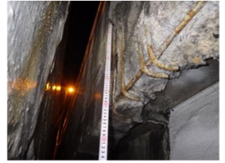
コンクリート高欄部の損傷 (剥離・鉄筋露出)
