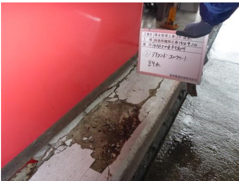
料金所アイランド損傷（補修前）
