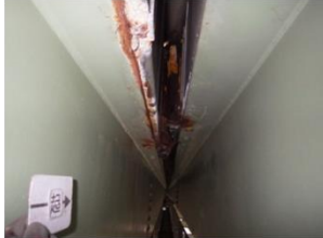
伸縮装置の損傷 (止水破損)
