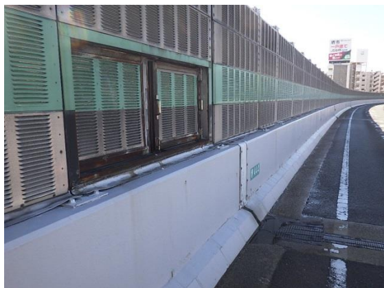
15号堺線：遮音壁さび腐食
