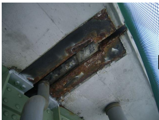
環状線 鋼桁端部さび・腐食（補修前）
