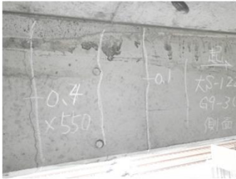
コンクリート桁の損傷 (ひび割れ)
