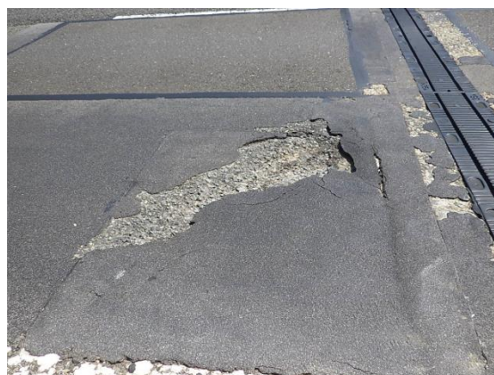
15号堺線：舗装はく離
