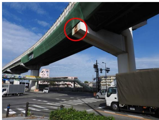
17号西大阪線：鋼製橋脚さび腐食
