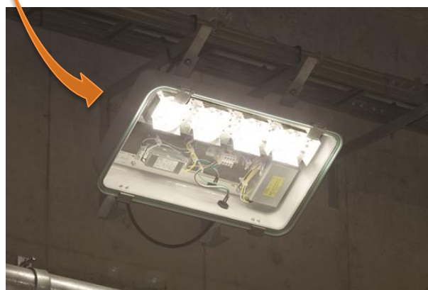
トンネル部道路照明 (LED)
