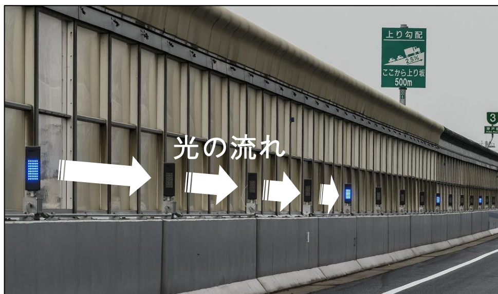
3号神戸線り深江サグ部における速度回復誘導灯
