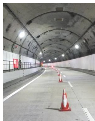
道路トンネル照明 (LED)
