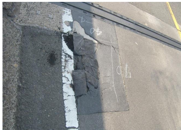
16号大阪港線：舗装穴
