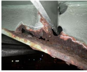
鋼桁部の損傷 (漏水による腐食)
