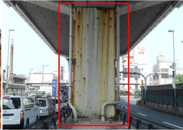
17号西大阪線：鋼板巻立て部さび腐食
