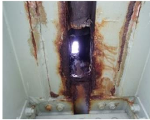
伸縮装置の損傷 (止水破損)
