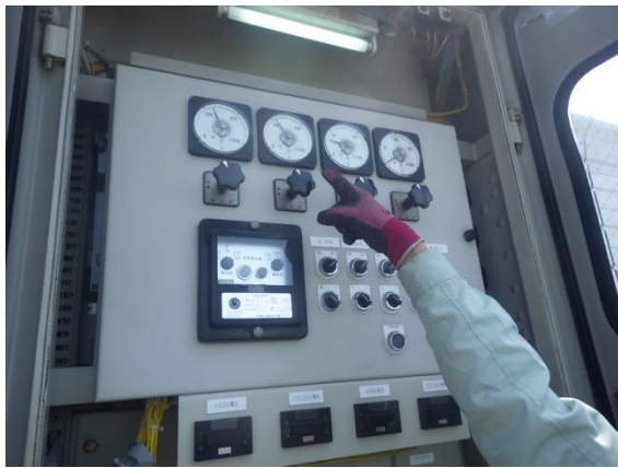
受変電設備点検
