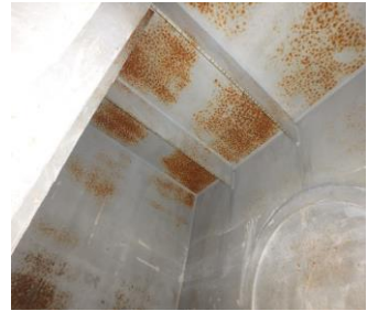
〔錆の状況(上面)〕
