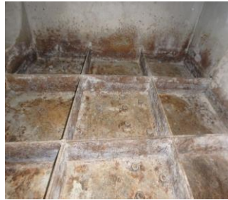
〔錆の状況(下面)〕
