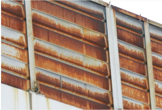
14号松原線：遮音壁さび腐食
