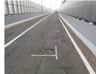
舗装の損傷 (ひび割れ)
