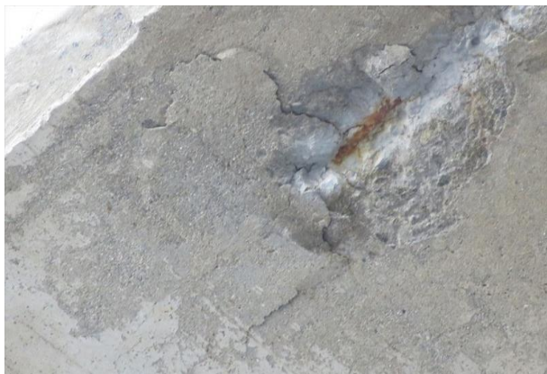
12号守口線：さび片の落下恐れ
