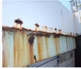
鋼製高欄部の損傷 (漏水による腐食)
