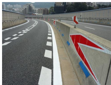
注意喚起矢印板 (7号北神戸線 妙法寺カーブ)
