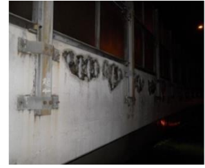
コンクリート高欄部の損傷 (剥離・鉄筋露出)
