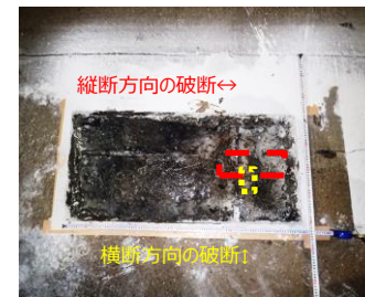
PC鋼材の破断
