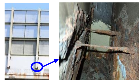
投棄防止柵支柱のアンカー部の減肉 (16号大阪港線 阿波座付近)
