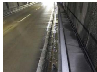
トンネル内湧水
