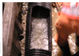
【排水管内の遊離石灰堆積状況】
