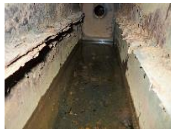
高欄内の滞水 (3号神戸線 府県境付近)
