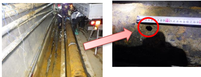
劣化した消火用配管の損傷状況
