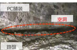
【PC舗装と路盤間の空洞】
