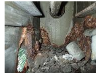
高欄内部の著しい断面欠損・発錆 (11号池田線 梅田付近)
