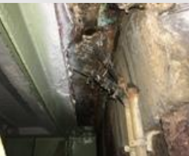
A_補強板腐食 (伸縮)
