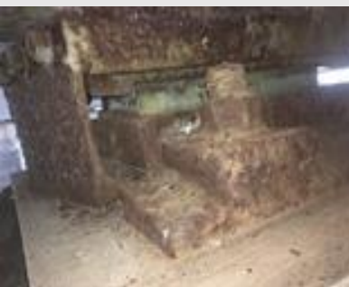
A_著しい腐食 (支承)
