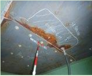
A_さび・腐食・断面減少 (補強済鋼板)
