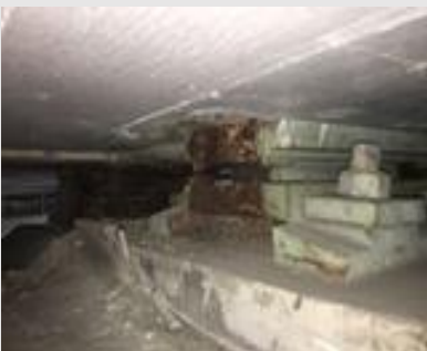
A_欠損・変形 (支承) (サイドブロック欠損)
