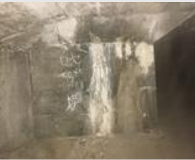
A_漏水・遊離石灰 (ダイヤフラム)
