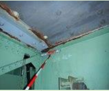
A_さび・腐食・断面減少 (上フランジ下面)
