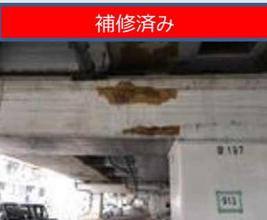
A_鉄筋腐食 (橋脚梁)
