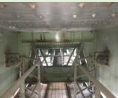
A_床端端横桁からの浮き (床版端部)
