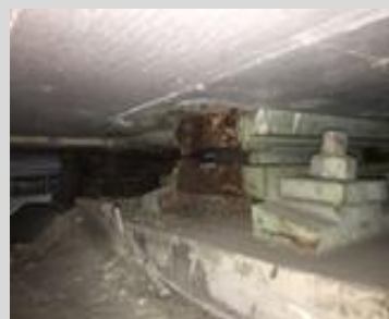
欠損変形 (支承)
