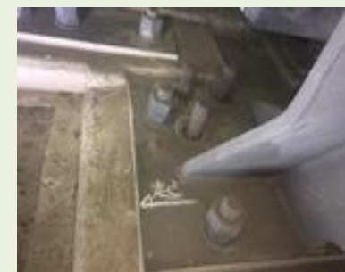
ボルト欠損 (落下防止装置)
