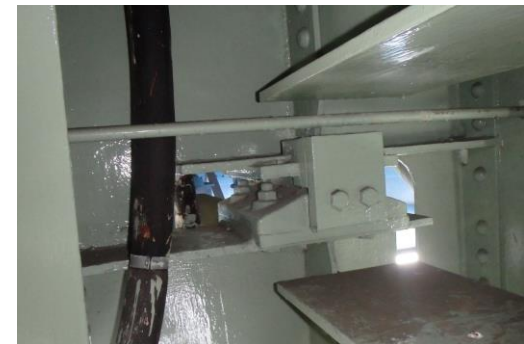
ゲルバーヒンジ部の現状
