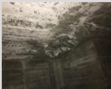
漏水・遊離石灰 (上フランジ下面)
