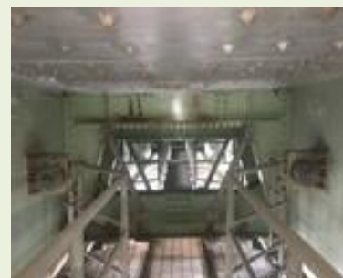
床版端横桁からの浮き (床版端部)
