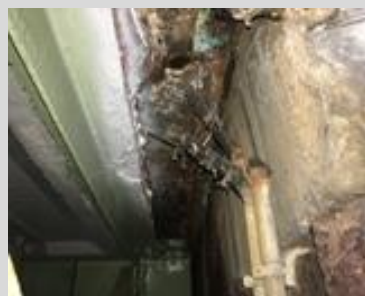
補強板腐食 (伸縮)
