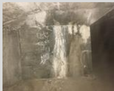
漏水・遊離石灰 (ダイヤフラム)
