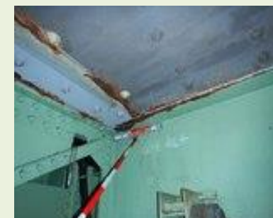
さび・腐食・断面減少 (上フランジ下面)
