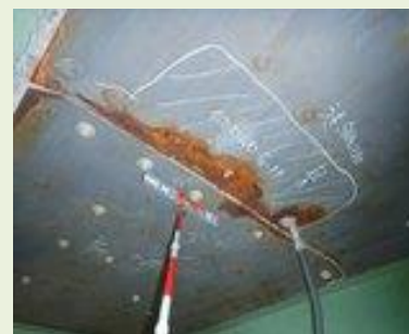
さび・腐食・断面減少 (補強済鋼板)
