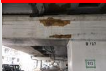
鉄筋腐食 (橋脚梁)
