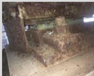
著しい腐食 (支承)
