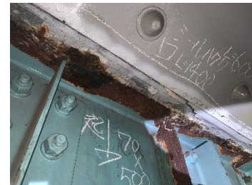
補強鋼板の腐食 (3号神戸線)
