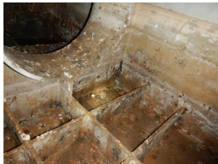
鋼製フーチングの内面の腐食
