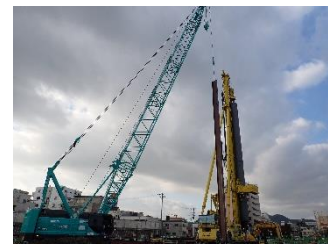
駒栄地区 連続地中壁による土留工 (大阪湾岸道路西伸部：建設中)
