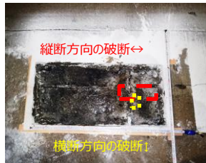
PC鋼材の破断
