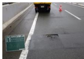
舗装の穴ぼこ (ポットホール)
