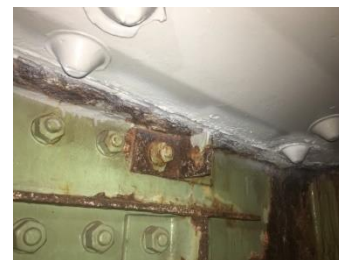
補強鋼板からの漏水、鋼桁の発錆 (12号守口線)
