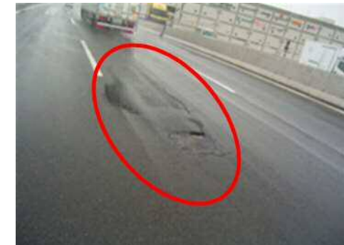
舗装損傷状況
