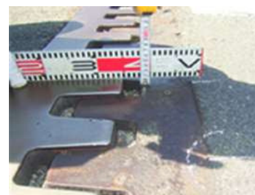
鋼製伸縮継手の損傷
