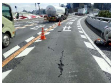
舗装の劣化・損傷
