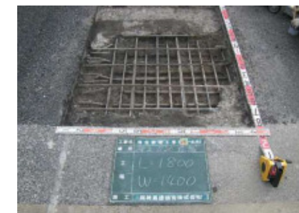
コンクリート床版の損傷 15
