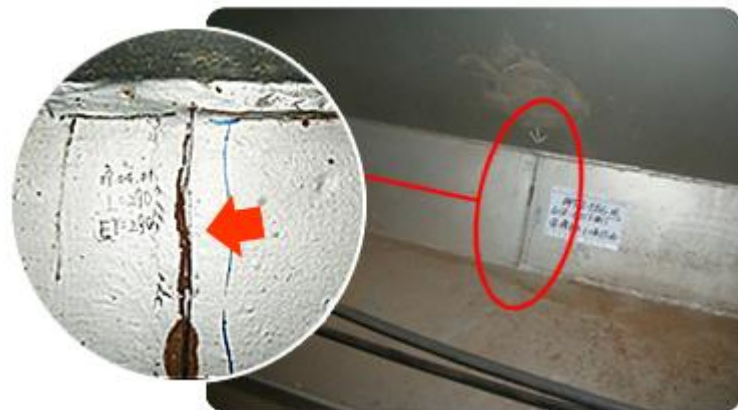
コーナープレート溶接部分の疲労き裂
