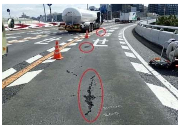
1号環状線の舗装の損傷状況
