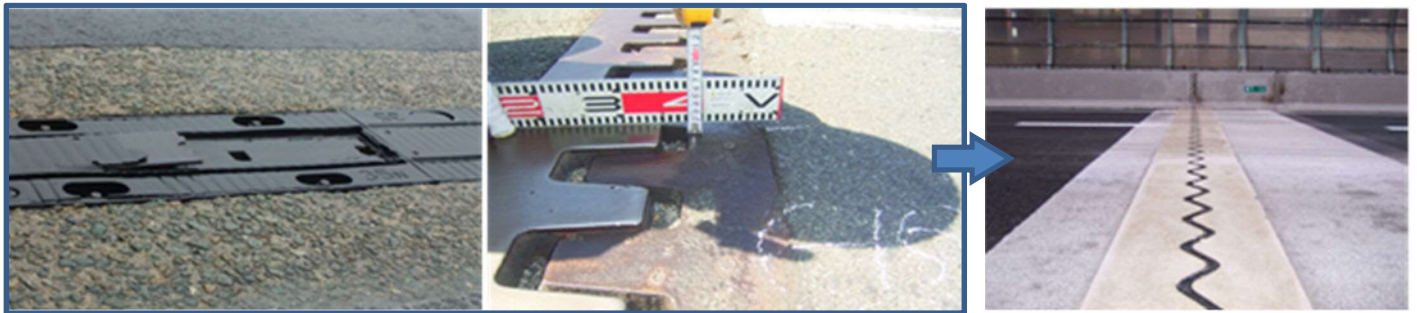
損傷事例(ゴムジョイントのはがれ) 損傷事例(鋼製ジョイントの浮き・段差)
