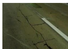
舗装面のひび割れを発見 (H28.12)
