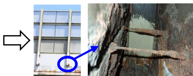
鋼製高欄内部の腐食 (16号大阪港線)
