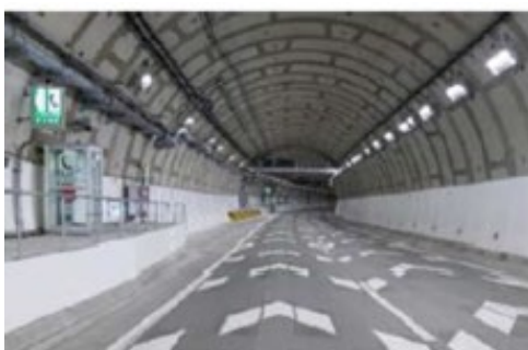
■LED道路照明（トンネル内）
