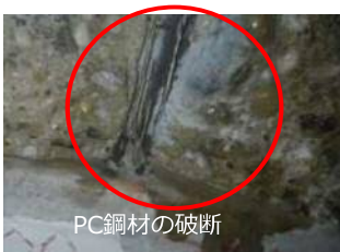
間詰部の抜け落ち、PC鋼材の破断 (11号池田線、2018年8月撮影)
