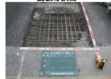
コンクリート床版の損傷
