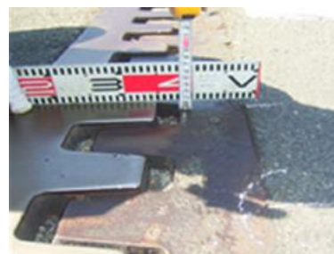
鋼製伸縮継手の損傷
