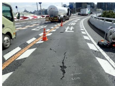
舗装の劣化・損傷
