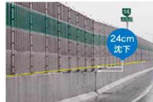
橋桁の中央付近が設計時の想定よりも大きく沈下
