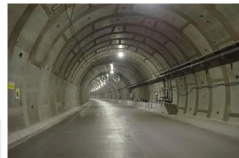
シールドトンネル部 施工状況 (コンクリート舗装完了部)
