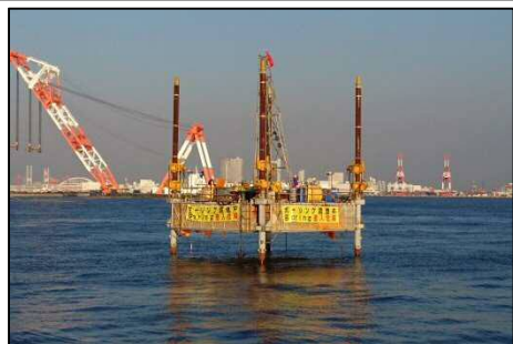
大阪湾岸道路西伸部 地質調査実施状況 (近畿地方整備局実施)
