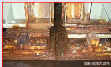
鋼桁の損傷状況
