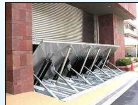
防潮板の設置
