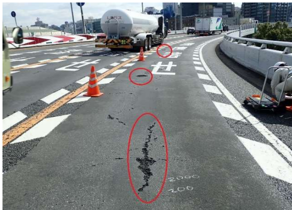
舗装損傷の多発状況
