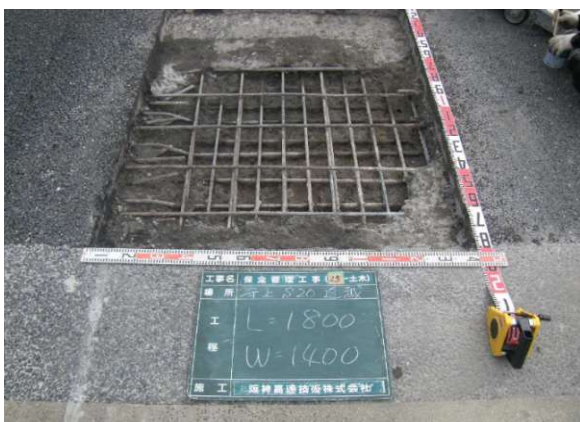
コンクリート床版の陥没
