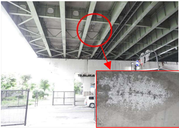
ひび割れ等の発生
