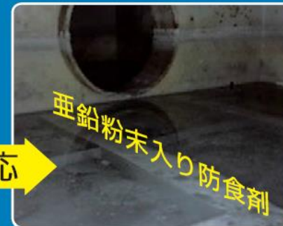
応急対応と滞水(現況)
