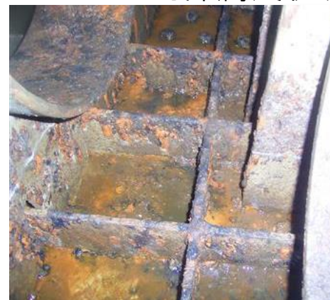
腐食による断面減少
