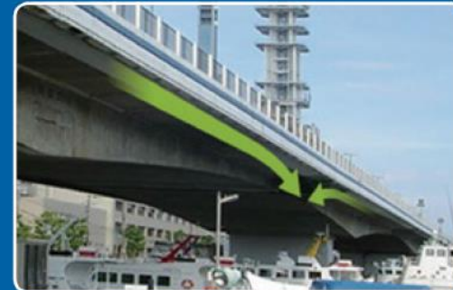
中央部の垂れ下がりが進行する橋桁
