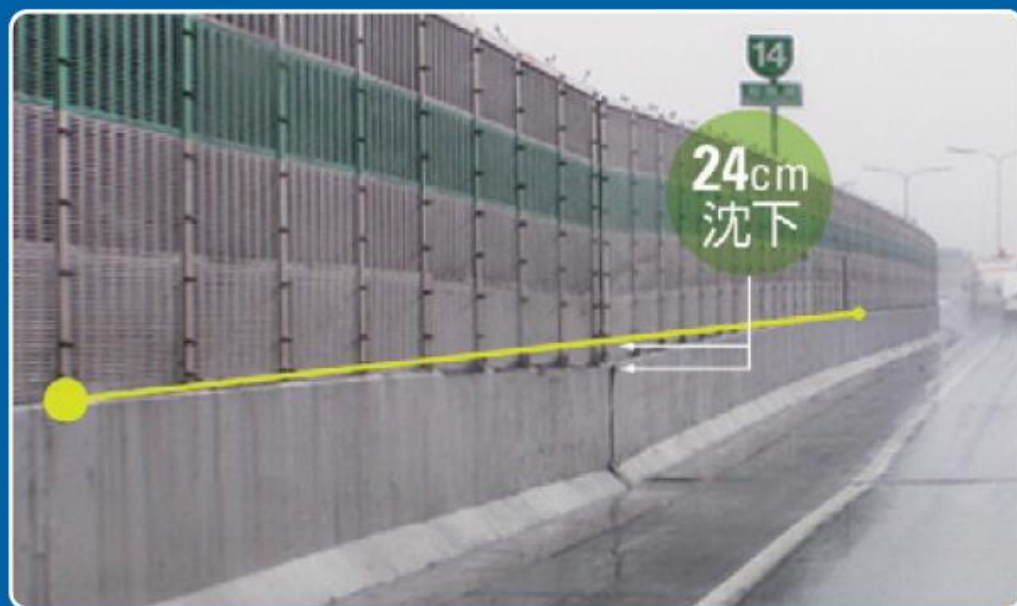
橋桁の中央付近が建設時の想定よりも沈下
