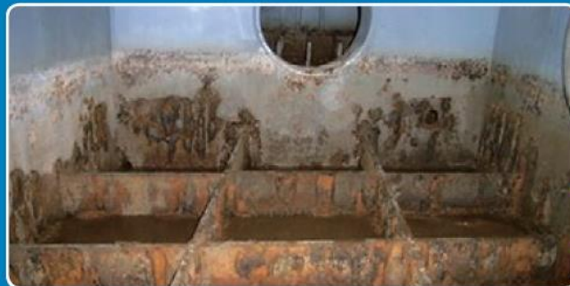
滞水の痕跡が残り腐食が進む鋼製の基礎内部
