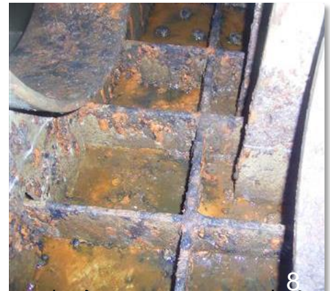
腐食による断面減少
