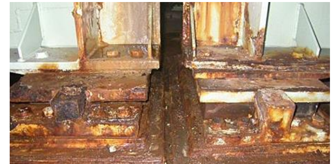
鋼桁端部の腐食
