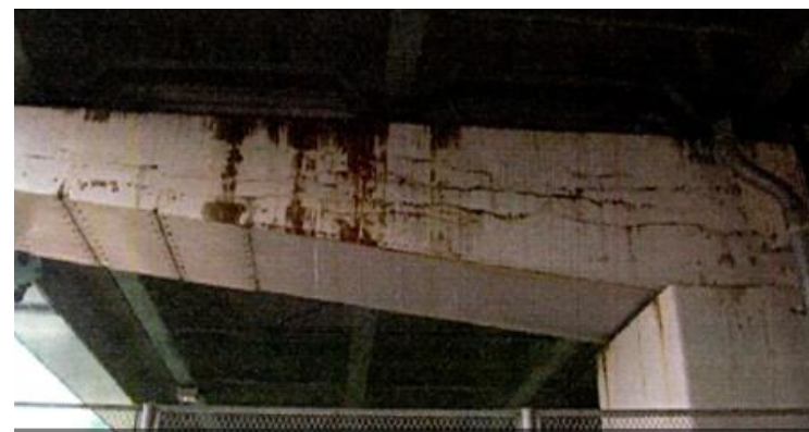
損傷が進んだ橋脚
